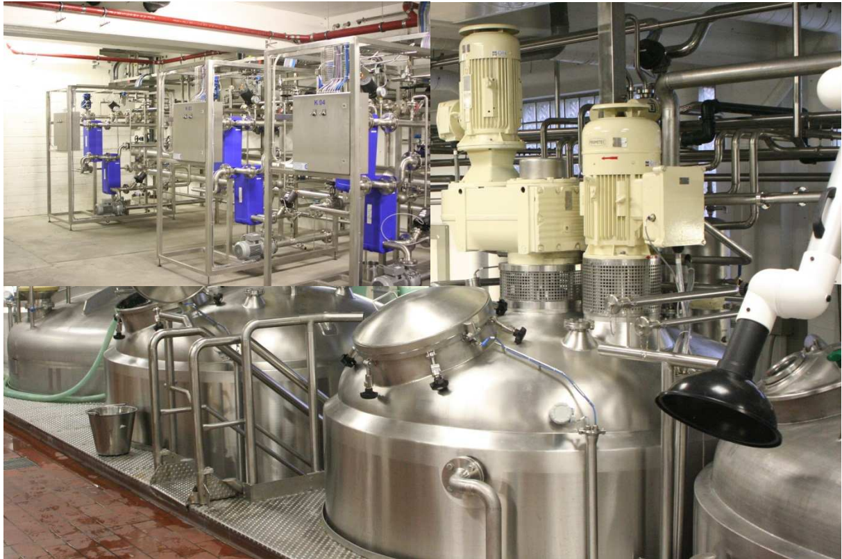
Steuerungen für Mischanlagen, Software und Hardware
